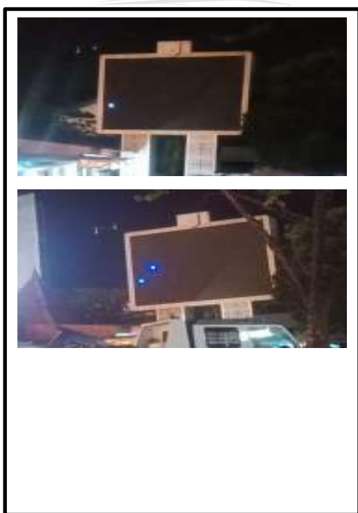
Videothrone Gelael Padam Setelah Pengecekan Kabel Yang Menghubungkan PC dan Prosesor Mengalami Kerusakan
